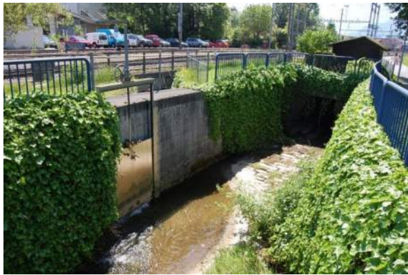
Abb. 27: Durchlass bei der Bahnlinie (links mit Schieber). Rechts der Entlastungskanal.
