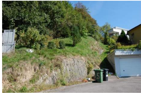
Abb. 40: Südexponierte Felsböschung am Waldrand zwischen Chäppeliweg und Stirnrüti. Die Böschung ist nur wenig bestockt und entspricht damit in etwa dem Ziel-Zustand.
