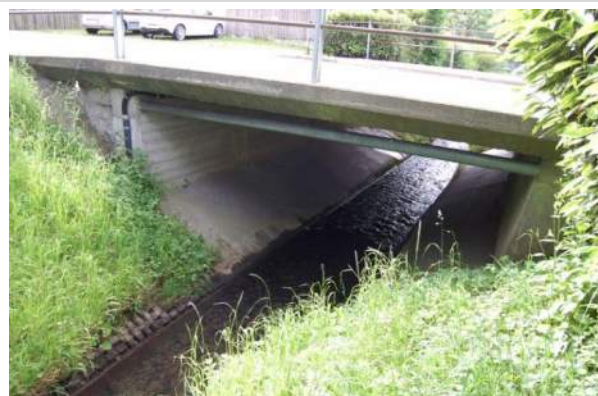
Abb. 6: Brücke/Unterführung bei der Schulhausstrasse. Durchgängigkeit für Kleintiere stark eingeschränkt.
